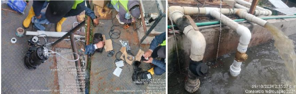
Ilustración 10. Instalación de equipos de tratamiento de agua residual CPAMSEB COMBITA
