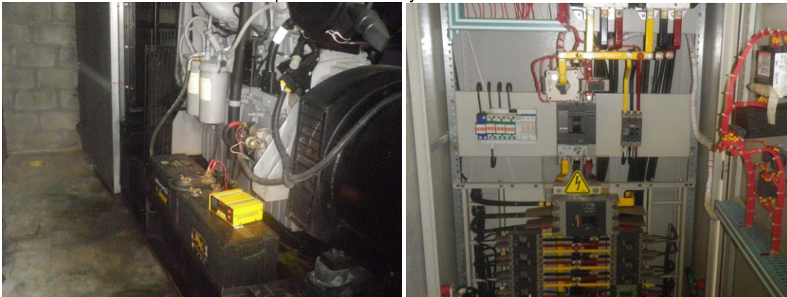
Ilustración 17. Mantenimiento de plantas eléctricas y subestación eléctrica EPMSC PTO TRIUNFO.
